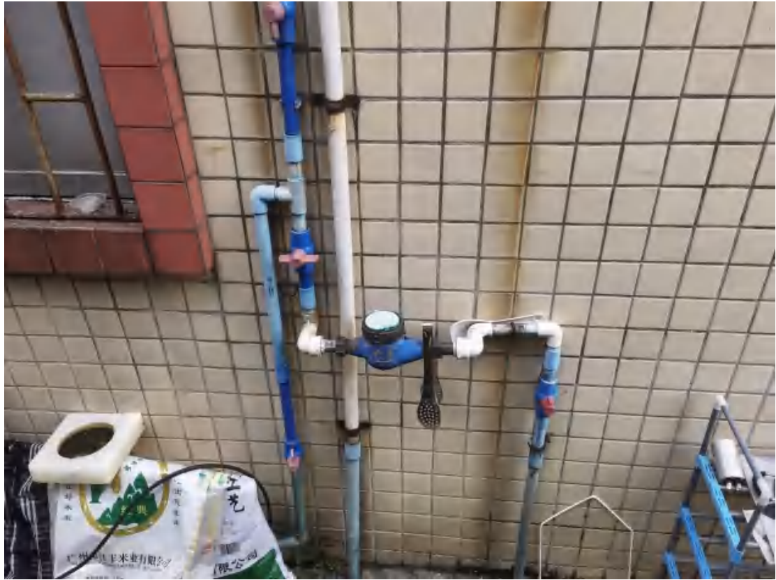
图 59 项目地块内部供水管现状（东南-西北）
