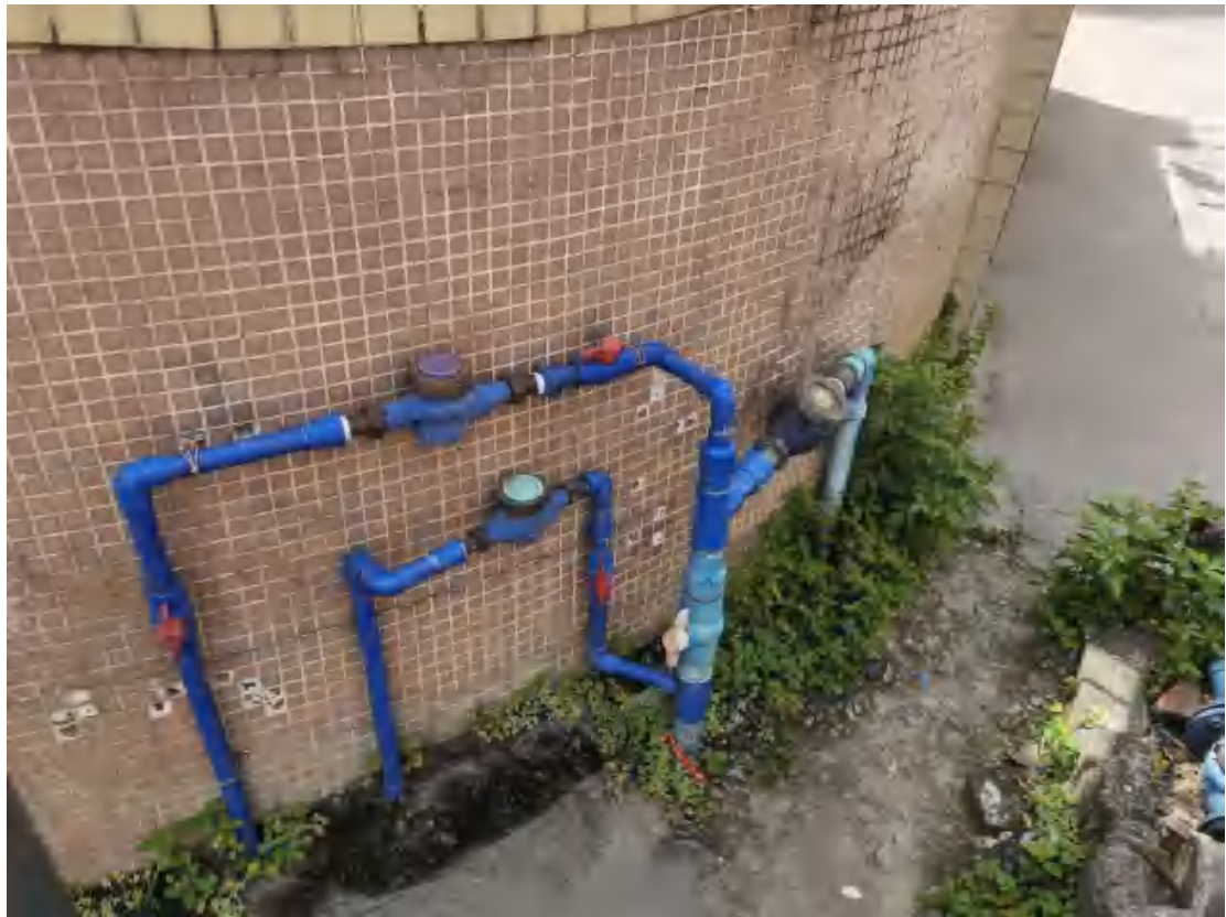
图 50 项目地块内部供水管现状（东南-西北）
