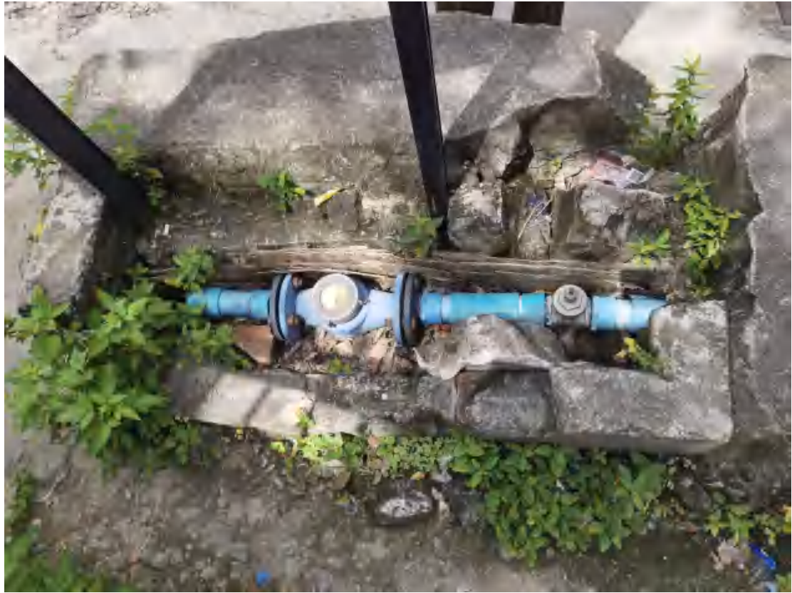
图 49 项目地块内部供水管现状（东南-西北）
