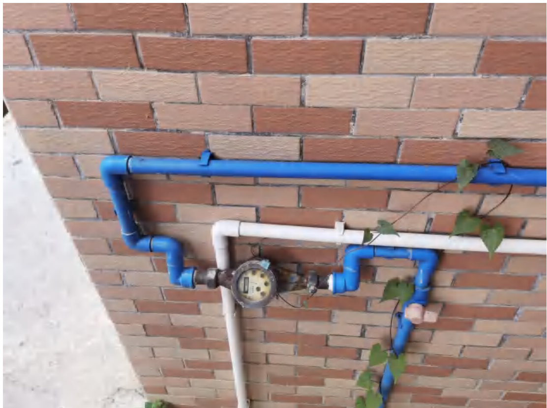
图 60 项目地块内部供水管现状（东南-西北）
