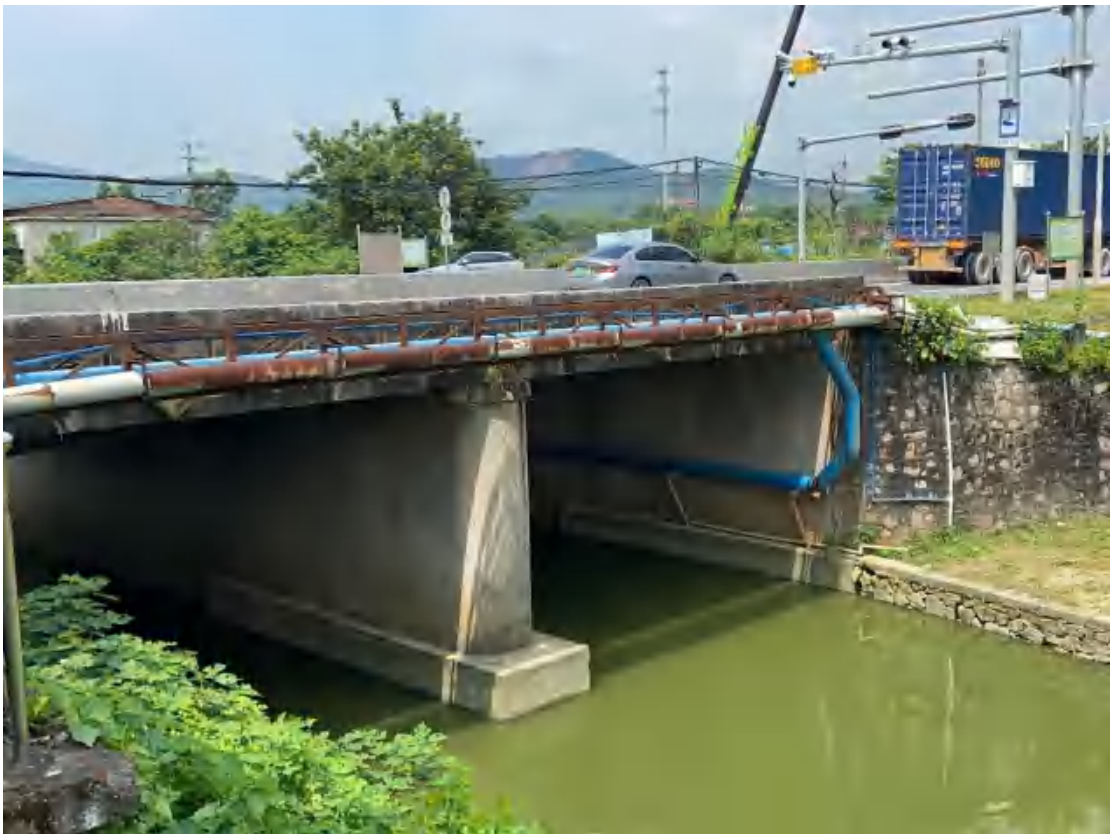
图 54 项目地块内部供水管现状（东南-西北）
