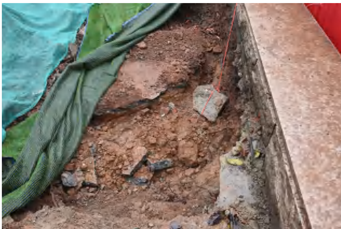
图 20 A 出入口及 1 号风亭地块内树坑现状
